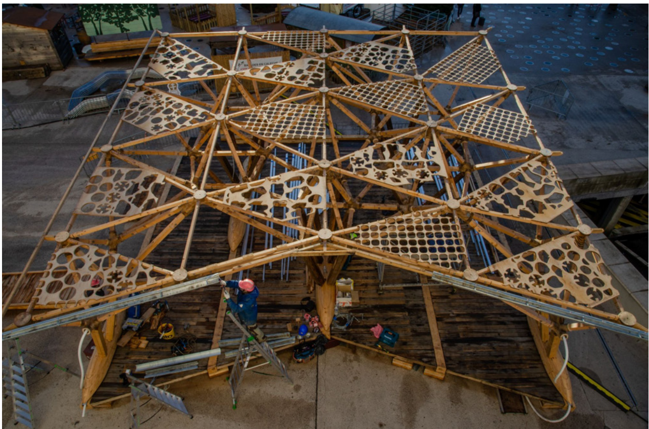
Photographie du pavillon Les Ram'eaux, Archi-Folies en construction. Travaux de la chaire partenariale « Architecture et Construction en Bois : du Patrimoine au Numérique ».
